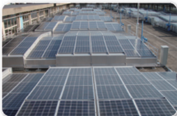
太陽光発電設備（金町浄水場）
