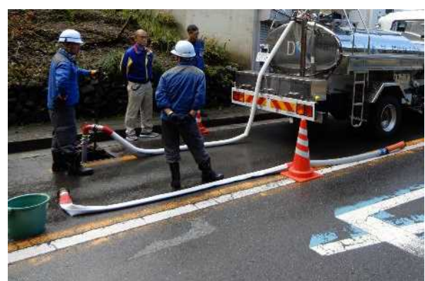
〔消火栓を活用しての注水〕
