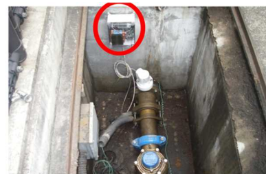
遠隔水圧計測装置を量水器付近に設置した例
