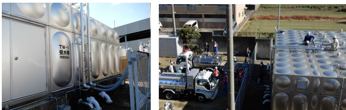
〔給水車専用入水管の設置例（大阪市「大阪急性期・総合医療センター」）〕
