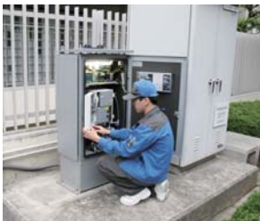
自動水質計器による監視
